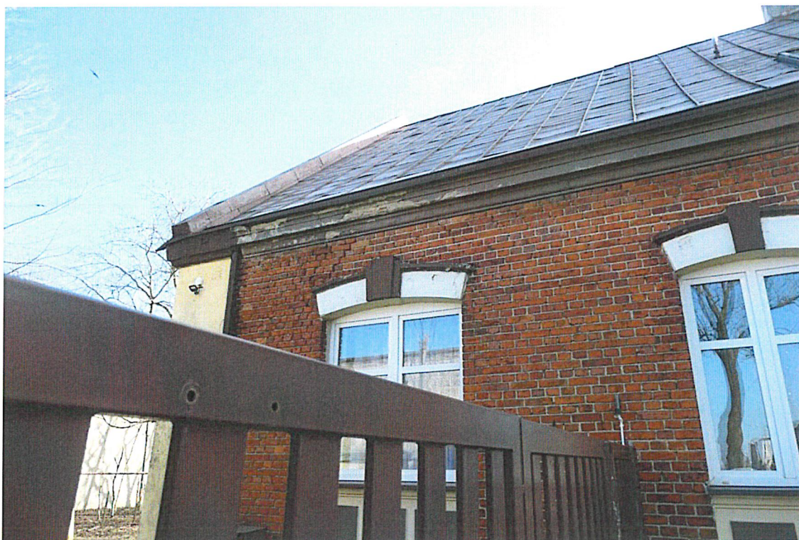
2. Fasada frontowa. Widoczne pęknięcia struktury murów nadproża.
