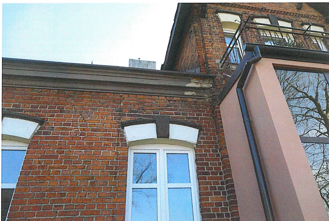
3. Fasada frontowa. Widoczne uszkodzenia gzymsu podokapowego.
