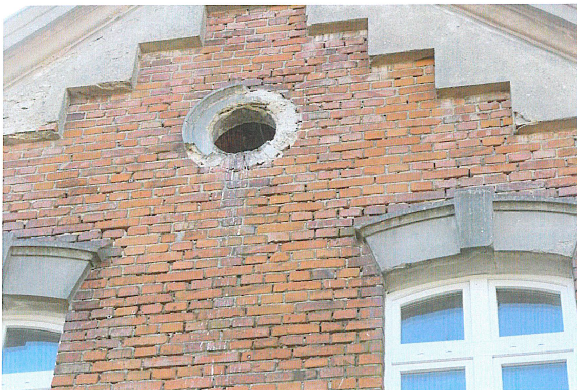
7. Fasada szczytowa. Widoczne uszkodzenia tynku.
