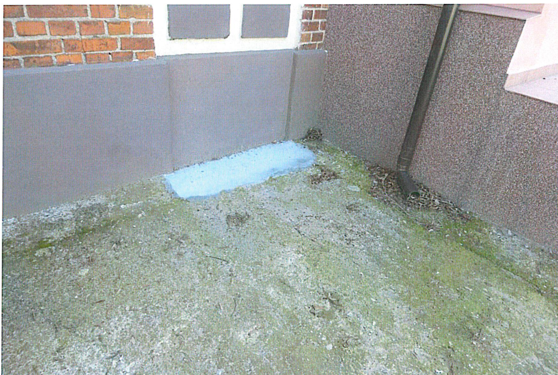
4. Fasada frontowa. Widoczna opaska betonowa.
